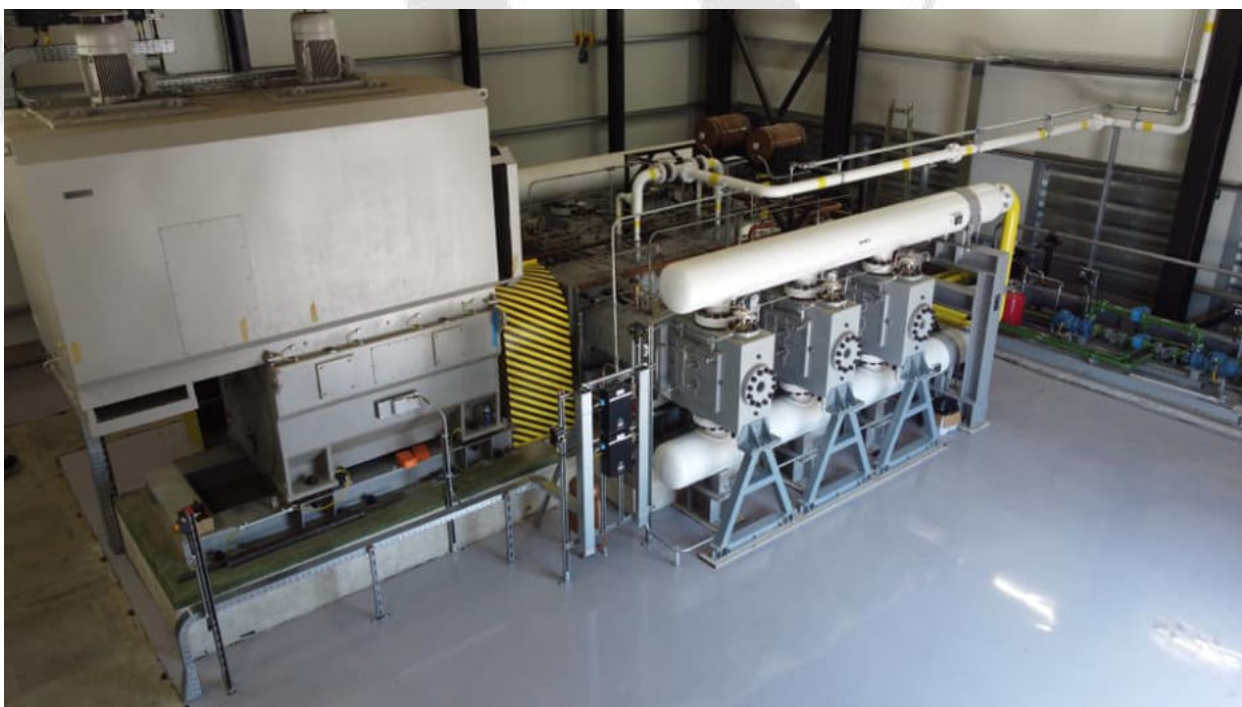
5. sz. kép - Új K-04-es villamos kompresszor csarnok
